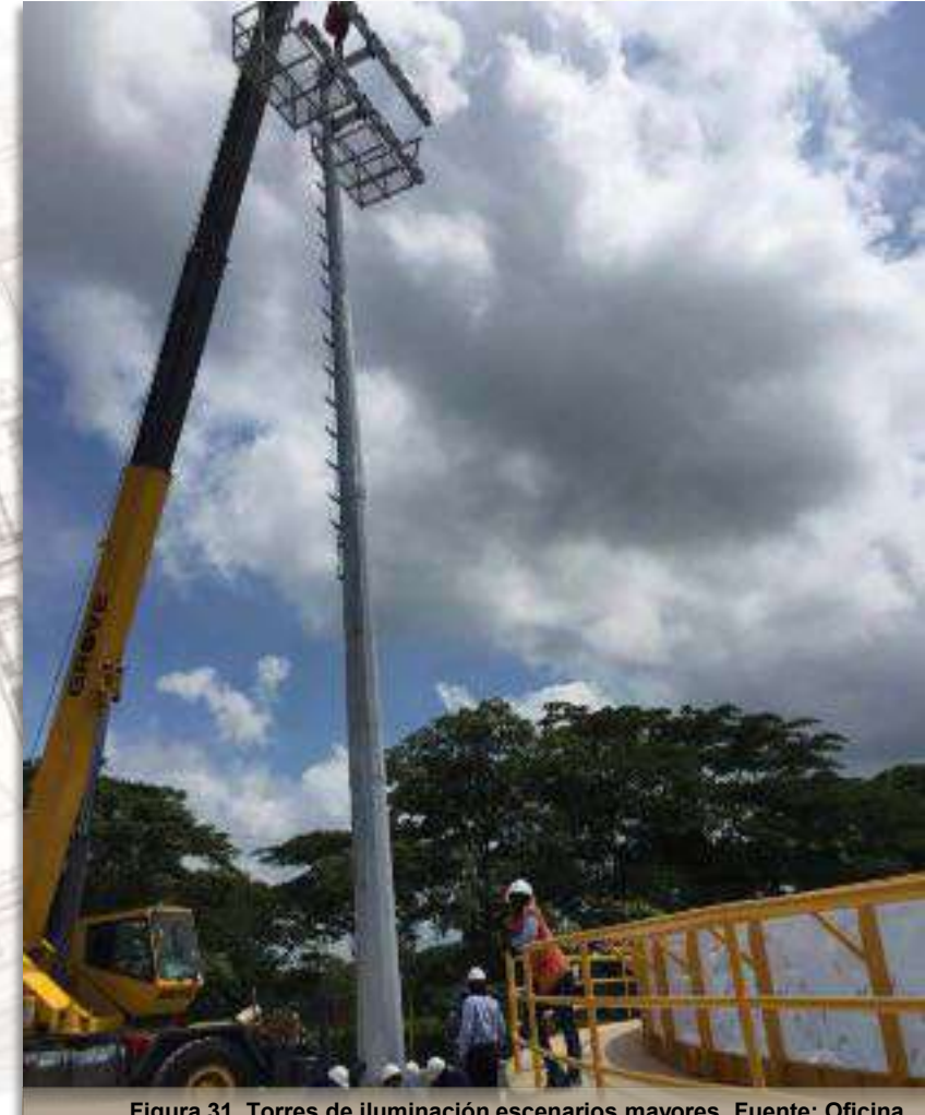
Figura 31. Torres de iluminación escenarios mayores. Fuente: Oficina asesora infraestructura - IDER.
