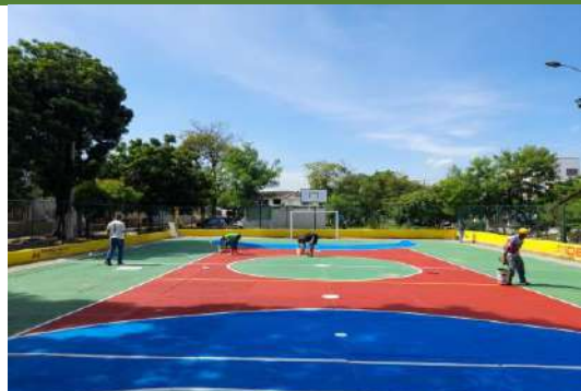
UD Cancha Múltiple Tiki Tiki después de las intervenciones realizadas
